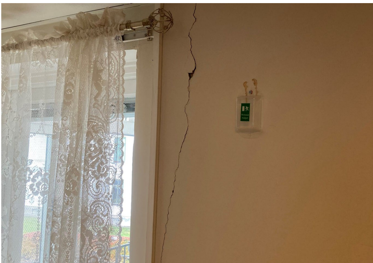
Bild 5. Exempelbild: Spricka vägg.
