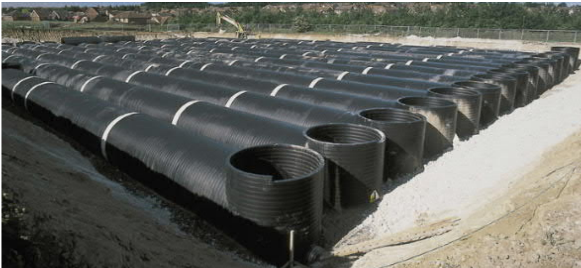
Foto 1. Exempel på rörmagasin (Stockholm Vatten).
